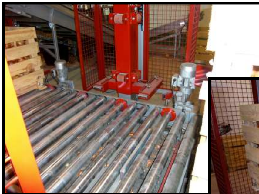
Detalle del sistema de carros de elevación de los cajones y del sistema de transportadores de rodillos.
