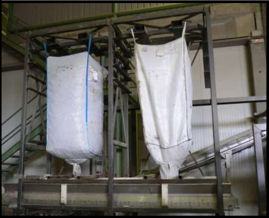
Estantería para dos sacas con una cinta transportadora inferior.
